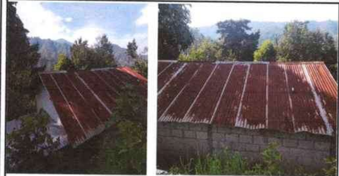
Foto 1: sustitución de lamina por oxidacion y filtracion de agua en tiempo de lluvia
