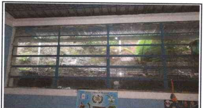
Foto 3: Por seguridad y para reguardar los bienes del edificio escolar es necesario la colocacion de balcones
