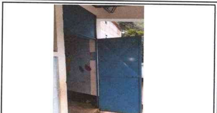
Foto 2: Mal estado de la base inferiores por oxido, cambio de ubicación, no tiene chapa y pintura en mal estado.
